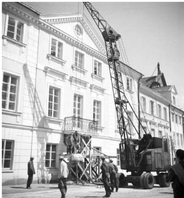
Rysunek 3. Prace wykończeniowe przy odbudowie kamienicy przy ulicy Freta 16 w Warszawie, ok. 1953 roku. Fot. Zbigniew Siemaszko, Narodowe Archiwum Cyfrowe Figure 3. Finishing works on the reconstruction of a tenement house at 16 Freta Street in Warsaw, around 1953. Photo Zbigniew Siemaszko, National Digital Archives
